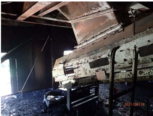
【焼損したコンベア】
